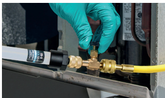
Cargue conductos con refrigerante
