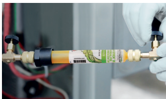
Cargue conductos con refrigerante
