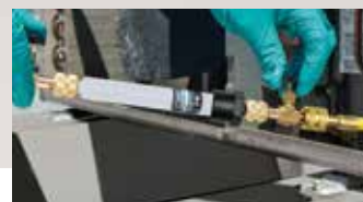
Charge en ligne avec le réfrigérant
